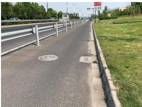
(5) 主线排水（市政雨水管）1
